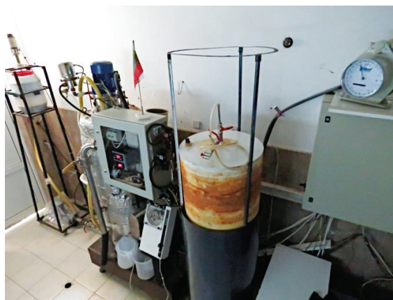
Фиг. 3. Общ изглед на пилотната биогазова инсталация
